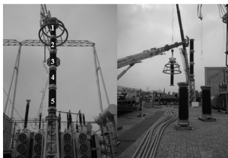
图2 1 000 kV避雷器支柱绝缘子
