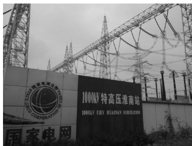
图1 淮南特高压变电站
